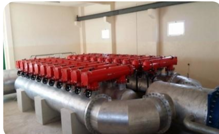
Station de filtration Secteur NFIS
